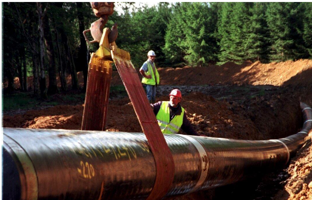
Les conduites de gaz ont leur propre cheminement, bien connu des randonneurs. Photo I.P.
